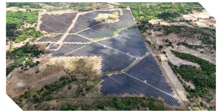
高耐食めっき鋼板 マレーシア 115 MW
