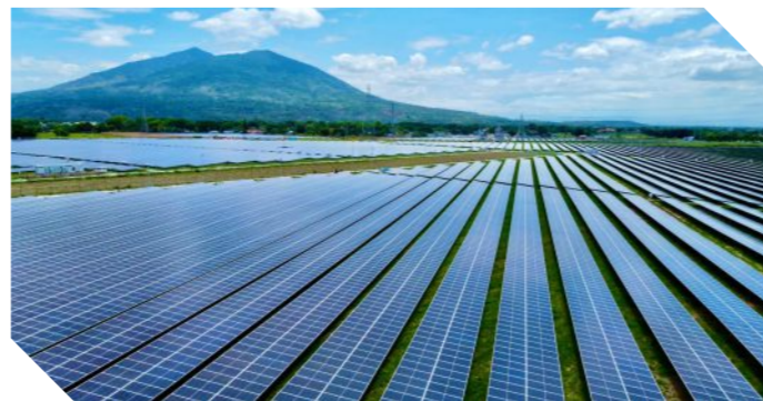
高耐食めっき鋼板 マレーシア 137 MW
